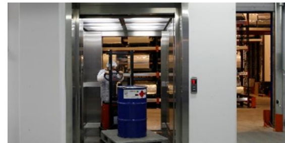
Ascensores de carga
