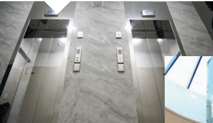
Wohngebäude 4 Line 1000 Aufzüge, Shunshig Villa, Mongolei
